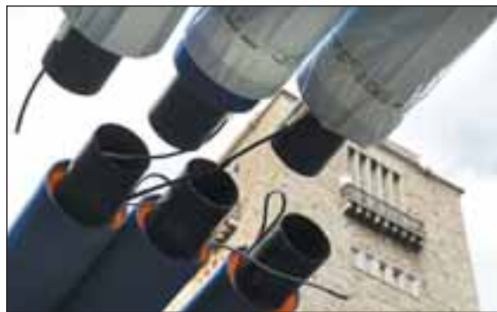
Rohre des Grundwassermanagements für das umstrittene Bahnprojekt Stuttgart 21 vor dem Turm des Hauptbahnhofs in Stuttgart. Foto: dpa
