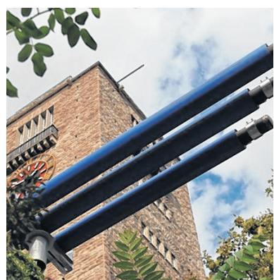
Diese Rohre dürfen vorerst nicht weiter verlegt werden. BILD: DPA
